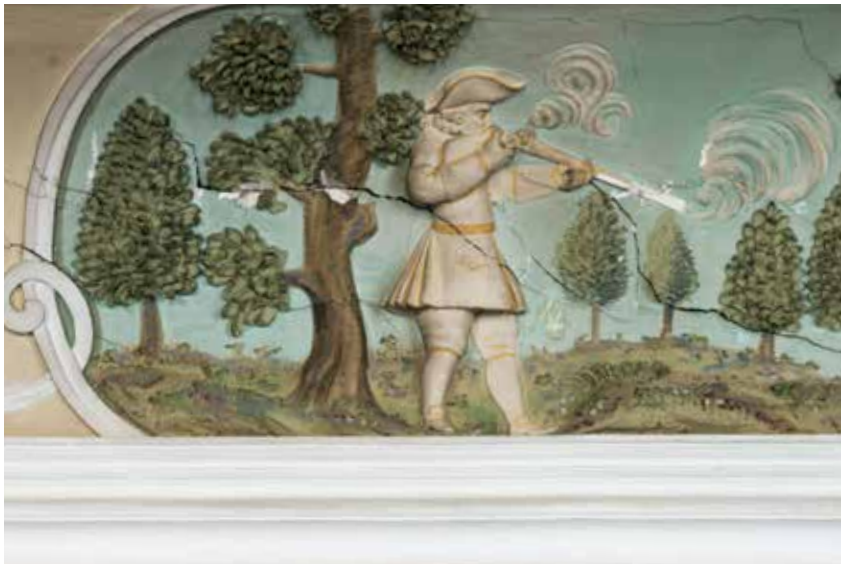
Die Stukkaturen in den Kehlen der Korridordecke des Obergeschosses (kleine Jagdszenen in Flachrelief) weisen Risse und Ausbrüche auf.
