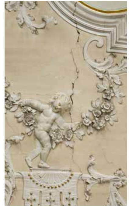
Viele Stukkaturen weisen Risse und Verschmutzungen auf.
